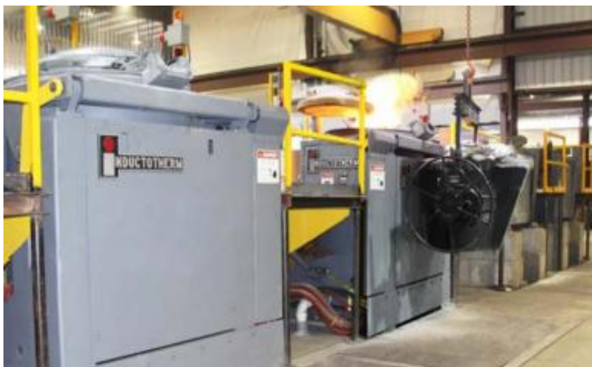
Рис. 2. Индукционная плавильная установка «Dual-Trak»
