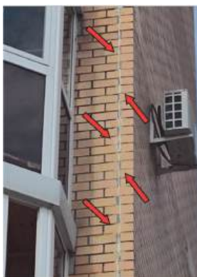
Рис. 5. Трещины в кирпичной кладке
