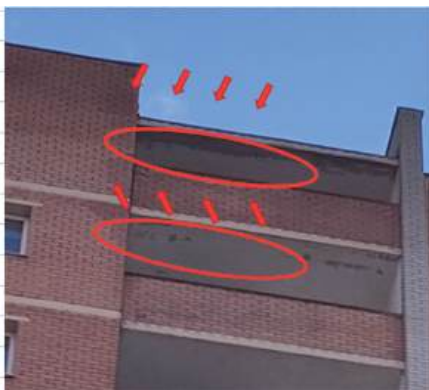
Рис. 4. Замачивание конструкций стен и плит перекрытий вследствие отсутствия сливных отверстий
