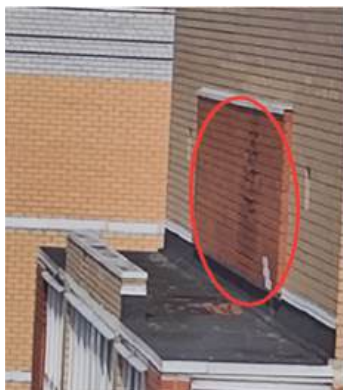
Рис. 3. Разрушение кирпичной кладки
